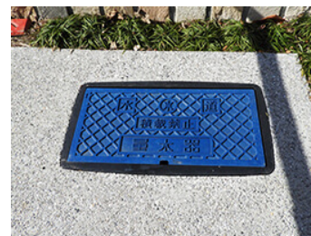
3 水道メーター 敷地内に検針員があまり立ち入ることなく スムーズにメーターを確認できる場所に 設置しています。
