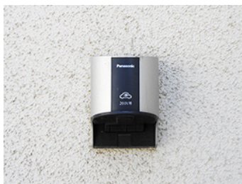
2 電気自動車充電用コンセント 電気自動車充電用の防水コンセントを外壁 に設置しています。
