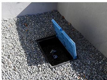
1 散水柱 庭とカーポートに設置。植木の水やりや、 洗車がしやすい位置に配置しています。
